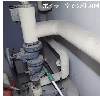
ボイラー室での使用例
